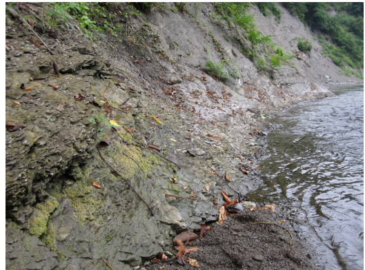
図3. 湧水の染み出している箇所。
